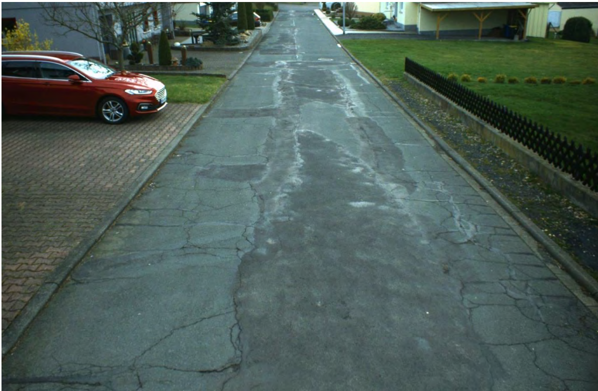
Schubertstraße (Setzungen, Risse; Ablösungen, Flicke)
