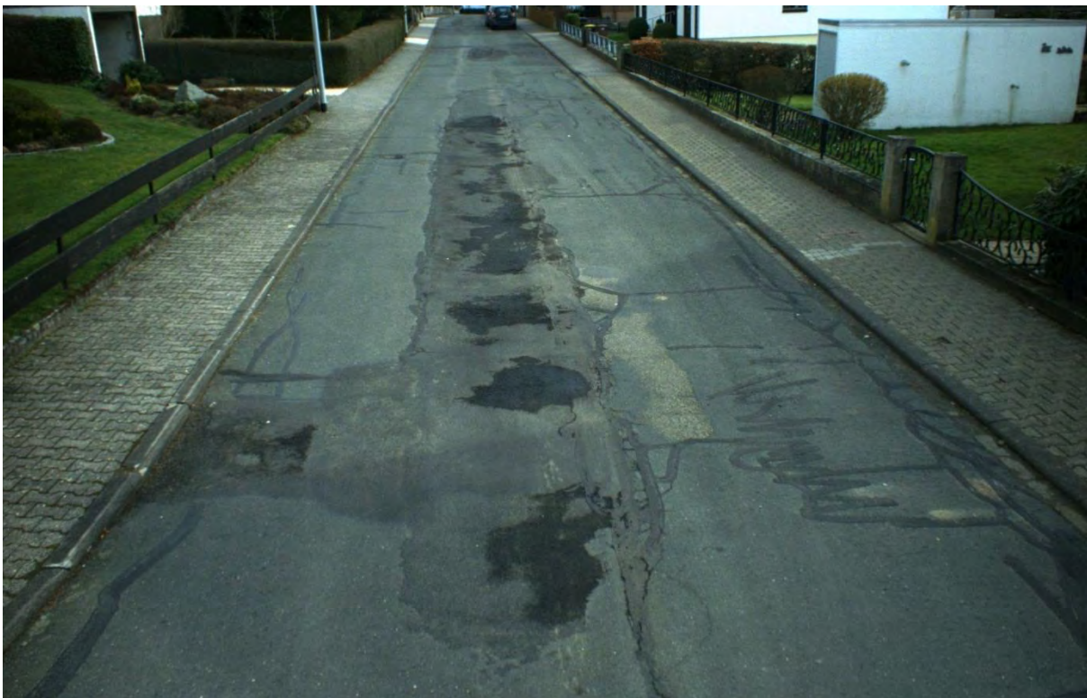
Rheingauer Weg (Setzungen, Ablösungen, Risse, Flicke)
