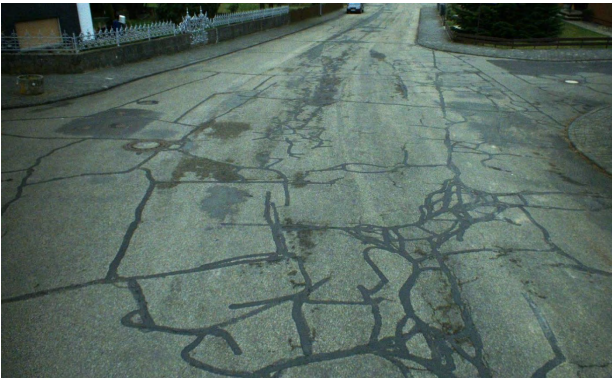
Brunnenweg (Setzungen, Risse, Flicke)
