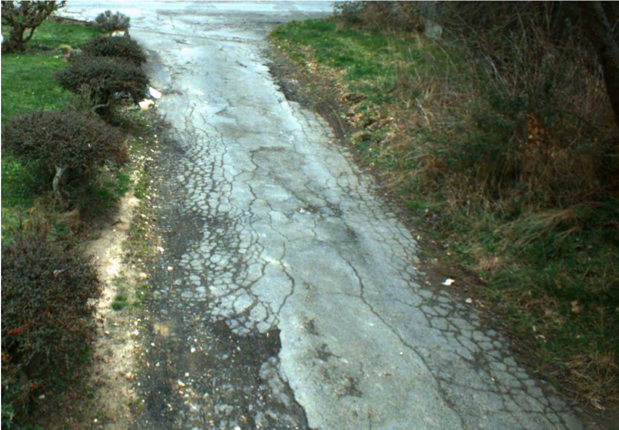
Brehmenstraße (Setzungen, Schlaglöcher, Risse)
